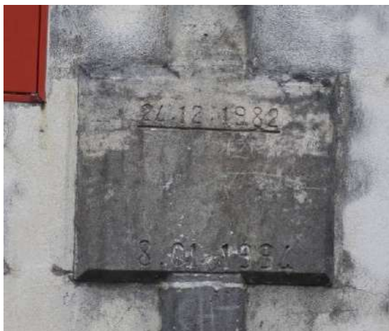
Marques de la montée des eaux lors des dernières inondations, le Chais
