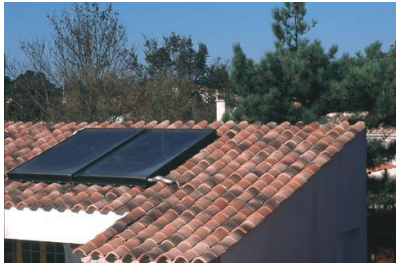
Capteurs solaires intégrés sur toiture neuve, Chéray
