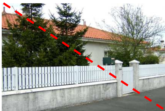
Travées et lisses en PVC à éviter
