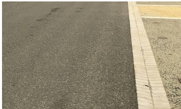
Caniveau pavé marquant la limite stationnement / voirie
