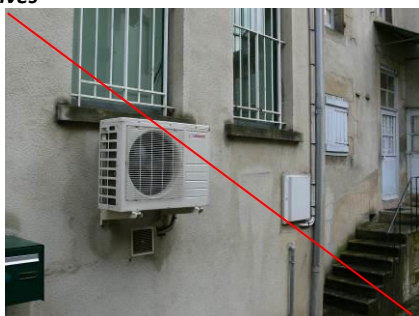
En surplomb de la façade à éviter
