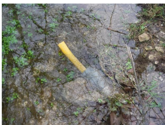
Sortie de drain (lieu-dit « Les Grands Arbres »)
