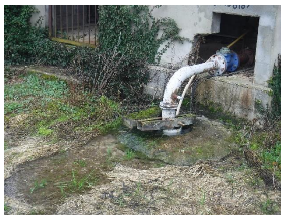
Station de pompage sur source (« La Martinière »)
