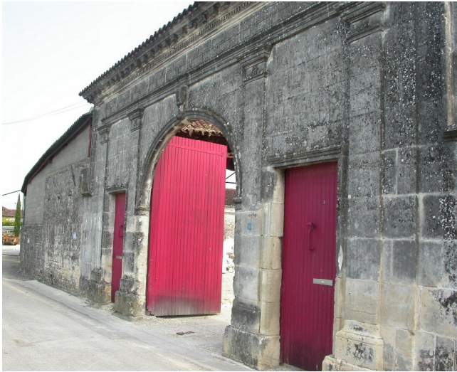
Portail composé d'une porte charretière et d'une porte piétonnière. Le tout est surmonté d'une corniche à modillons.
