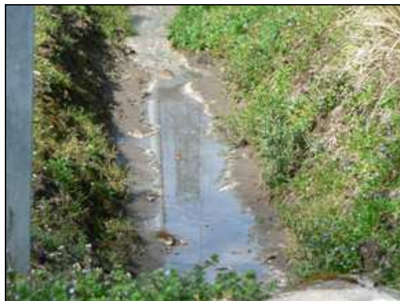
Mauvais fonctionnement d'un système d'assainissement individuel
