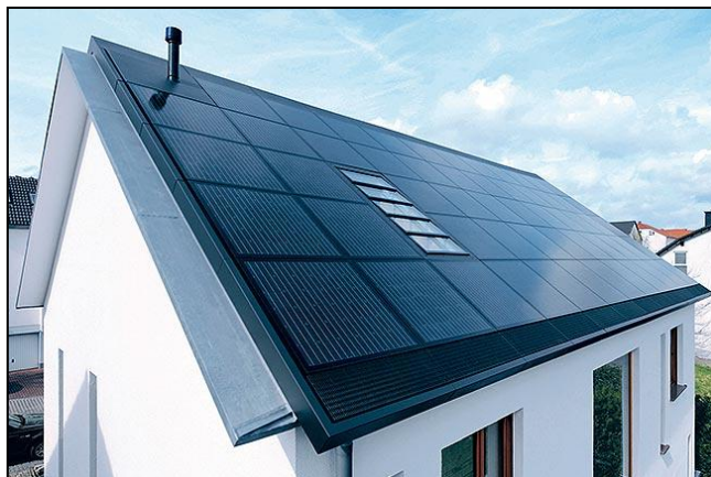
Panneaux photovoltaïques intégrés à la toiture
