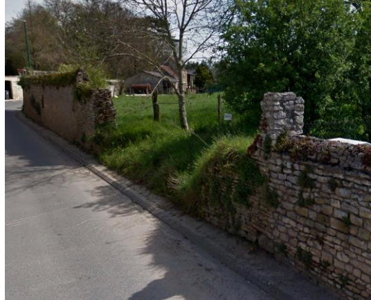
Partie effondrée du mur rue des Glengarrians
