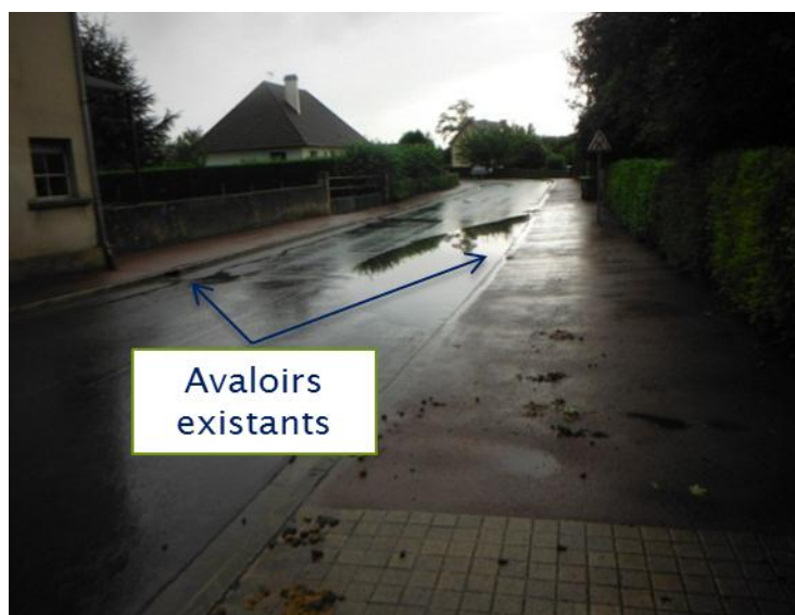
Fig. 28. Aperçu de la zone problématique
