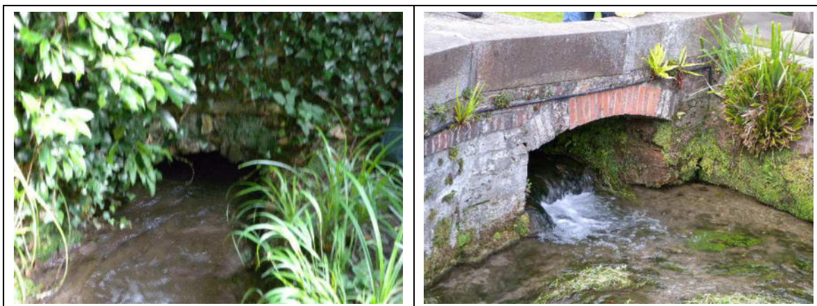
Figure 3-3 : entrée du souterrain, à gauche, et exutoire dans le lavoir, à droite.
