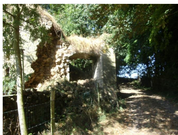
Bâti en pierres en ruine
