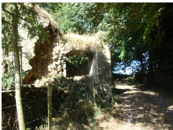
Bâti en ruine, chemin du Puits aux Anglais
