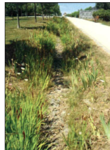
Noue d'infiltration avec couche d'empierrement
