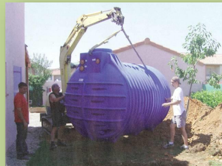
Cuve de réutilisation des eaux de toiture
