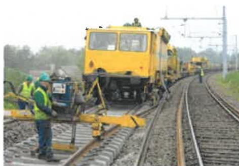
Longs Rails soudés sur traverses béton
