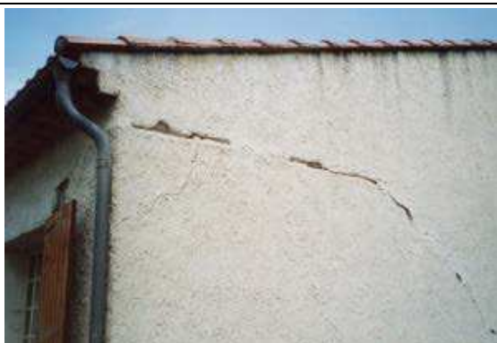
Fissures extérieures (Auteur BRGM Bureau des Recherches Géologiques et Minières)
