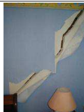
Fissures intérieures (Auteur BRGM Bureau des Recherches Géologiques et Minières)
