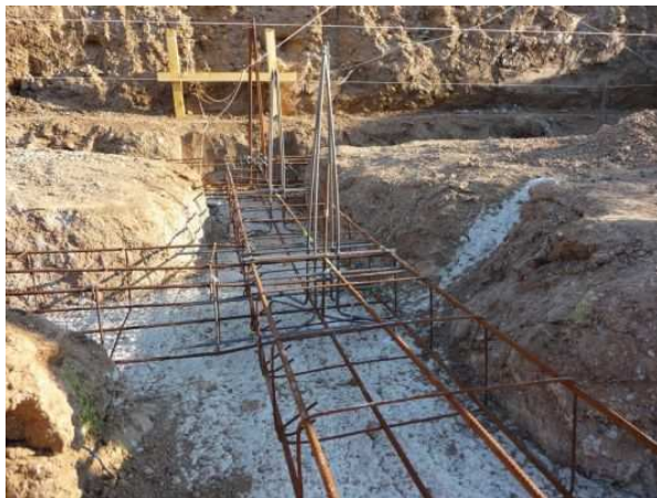
Exemple de continuité mécanique entre fondations et des fondations avec les chaînages verticaux ©Forumconstruire.com
