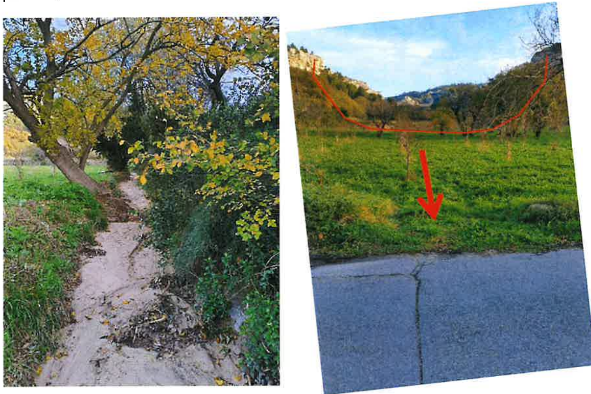
Image 13 : Fossé de drainage du village très encombré à l'est du val d'Enfer (à gauche) et partie centrale du val d'Enfer (à droite, photo mal orientée)
