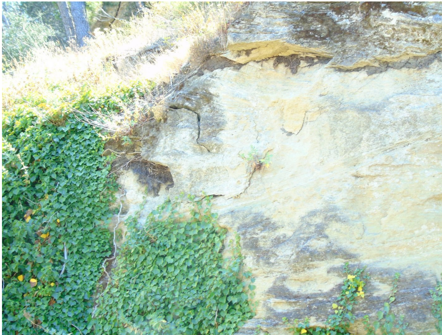
Figure 9: Exemple d'écailles partiellement décollée et de cicatrice fraîche de rupture.
