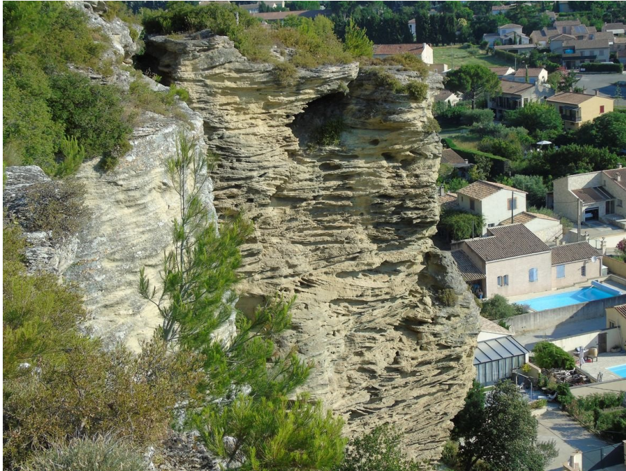
Figure 14: Le pilier du Petit Castel vu du Sud vers le Nord. La fissure à l'arrière du pilier est bien visible.
