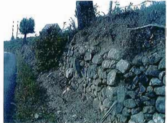
dégâts des intempéries
