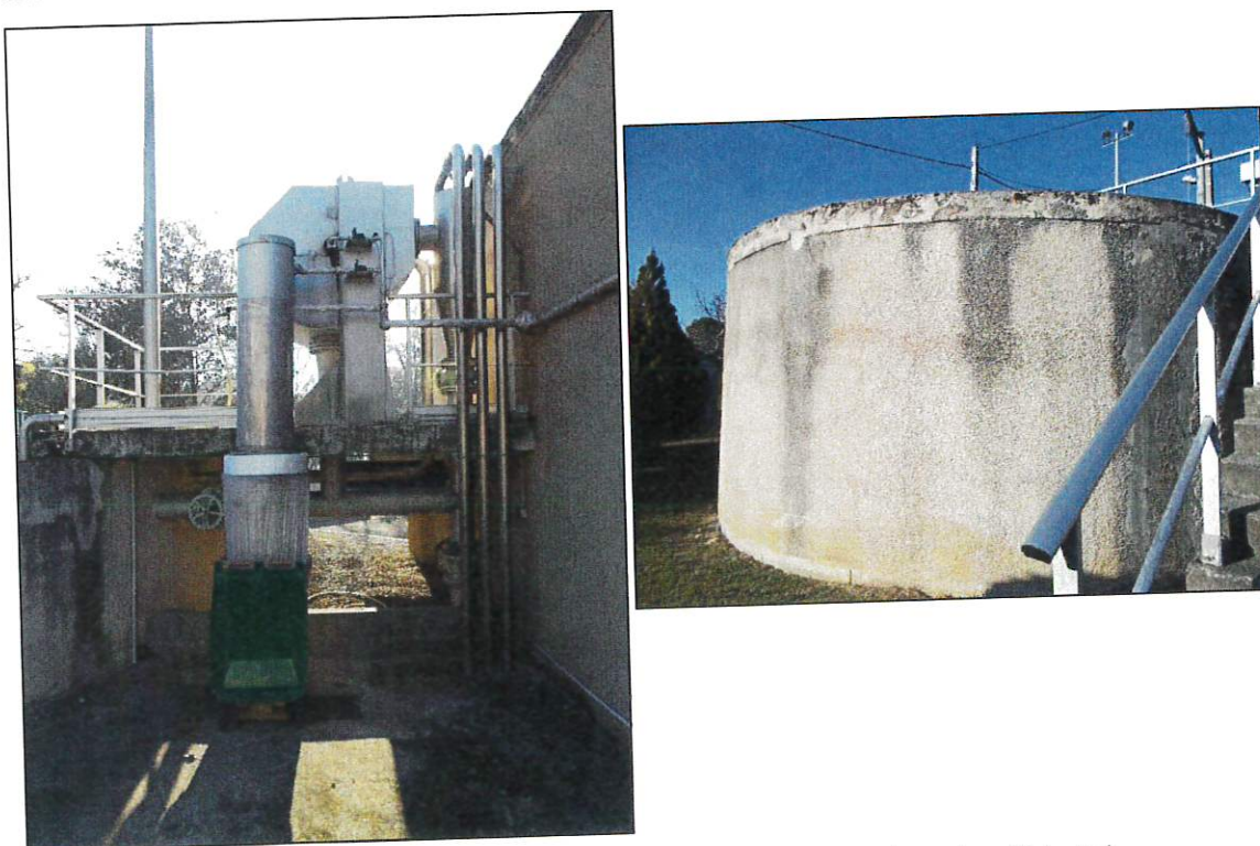
Figure 12 : Photos du silo à boues (à gauche) et du dégrilleur/ensacheur (à droite)
