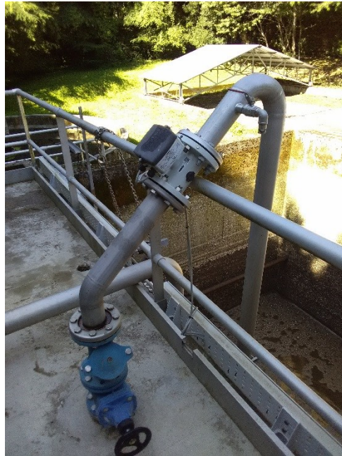
DEM file BOUES sur remplissage du silo (image SATESE 2021)
