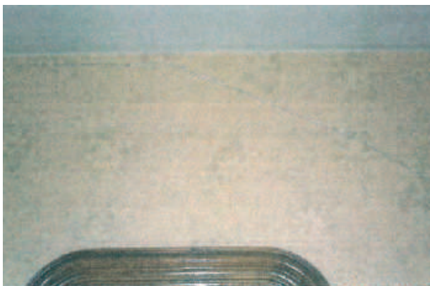
Fissuration intérieure, tapisserie déchirée - Maison André.
