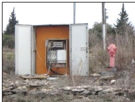
Transformateur et poteau incendie
