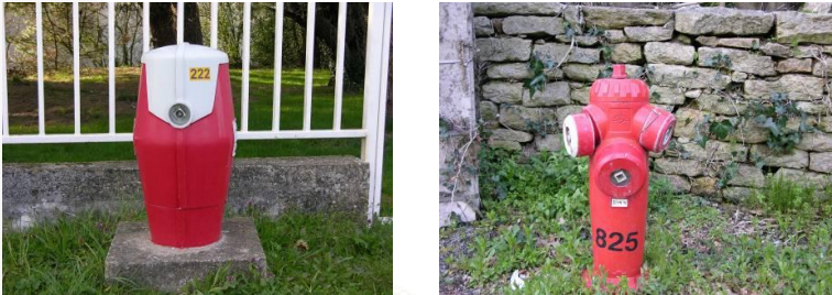
Exemples de numérotation de poteaux incendie
