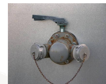
Prises directes de 100 mm sur réserve
