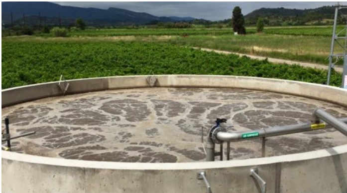
Image 15 : Station d'épuration de Conilhac-Corbières ; SOLIHA méditerranée, 2023
