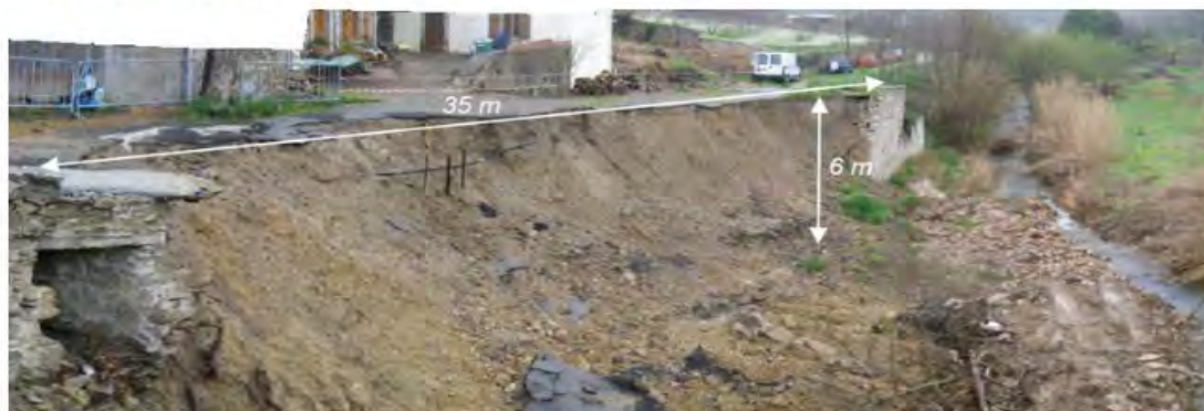
Eboulement constaté (BRGM le 4/4/2013)
