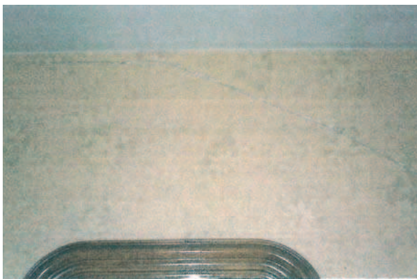
Fissuration intérieure, tapisserie déchirée - Maison André.
