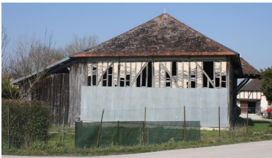
Grange dégradée rue des Charmottes
