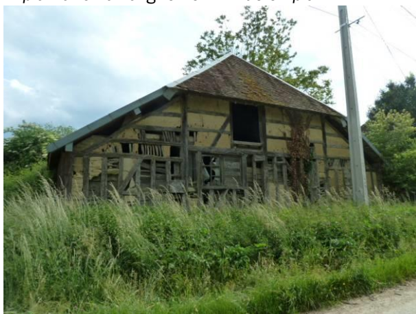
Bâti ancien demandant une importante restauration
