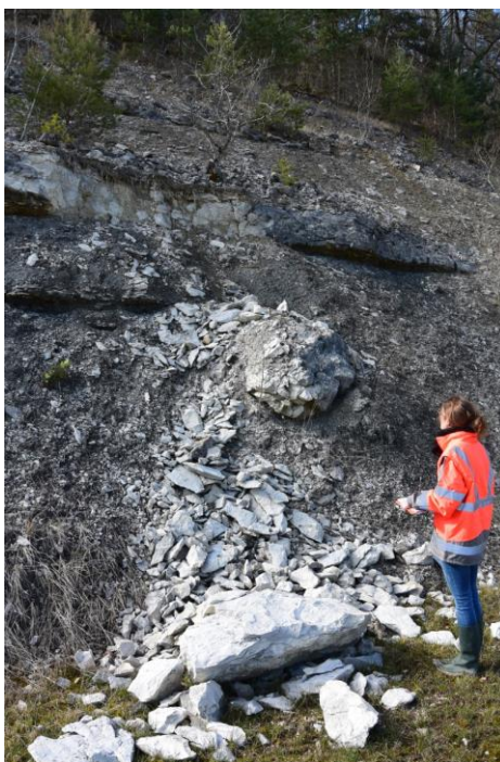
Illustration 10 – Eboulement rocheux récent (mars 2015, BRGM)
