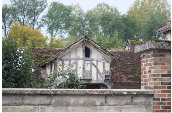
Bâtiment traditionnel délabré à Clérey-Haut
