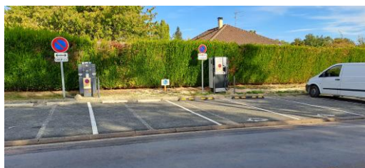
Photo 1. Bornes de recharge pour voiture électrique
