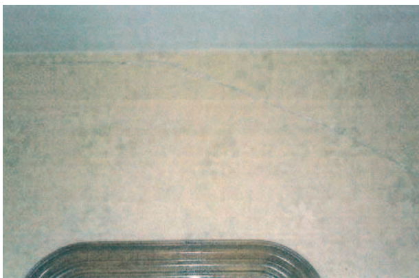
Fissuration intérieure, tapisserie déchirée - Maison André.
