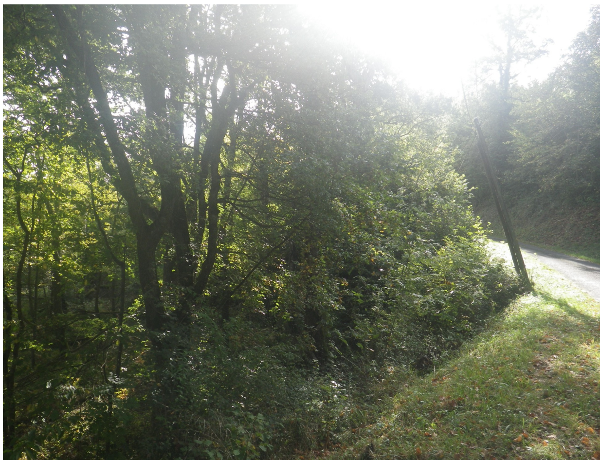
Figure 10 : Route à l'amont de Gelach : poteaux penchés, arbres en crosse et désordre sur chaussée (Source AGERIN)
