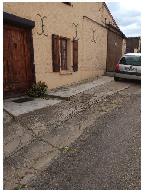
Trottoir dans le centre-ancien en mauvais état
