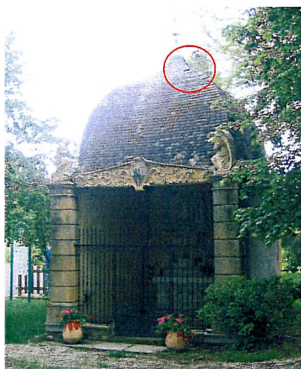
Chapelle oratoire de Lacave : toiture à rénover
