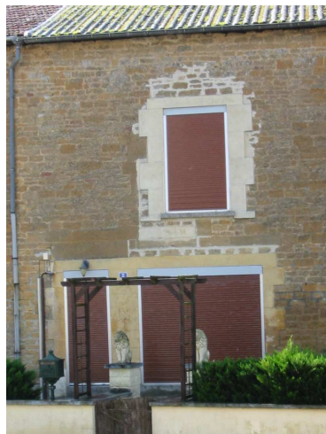
Des modifications de façades maladroites : modification des ouvertures....
