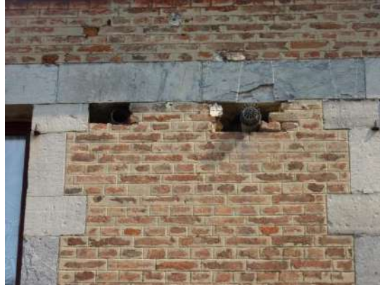
La façades de cette immeuble en briques a été ouverte maladroitement pour permettre l'évacuation de la chaudière à condensation.
