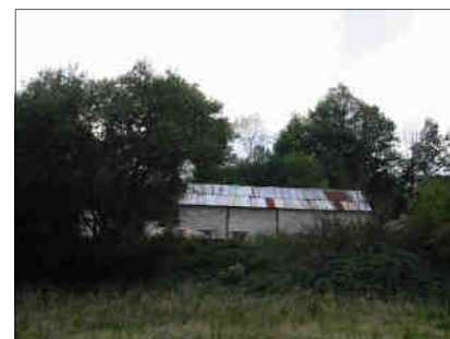
Vue sur le bâtiment d'aspect dégradé à partir de la R.D. 117
