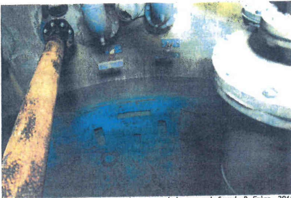
Réservoir du captage de la source du Sourd - B. Frère - 2011
