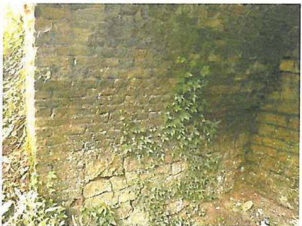
6. Pousse végétale au niveau des joints
