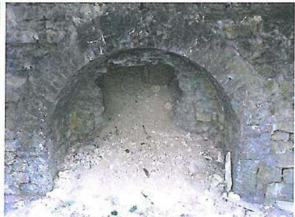
2. Éboulement de terre au cœur du four
