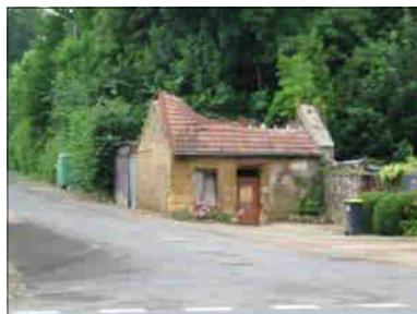
Dégradation apparente et prononcée de certaines habitations , à défaut d'occupation et d'entretien des bâtiments, dévalorisant l'environnement urbain. Elles mériteraient pour la plupart d'être réhabilitées.
