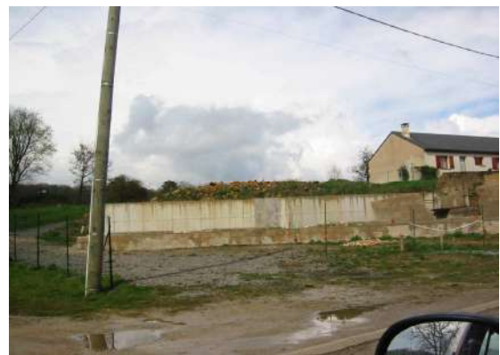
Points noirs ponctuels : murs à nu, dépôts, pentes de toitures ...
