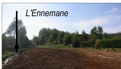
Vue sur le ruisseau à partir du chemin rural des Vignes. Des travaux d'aménagement sont en cours, de part et d'autre du ruisseau (aire sportive,...).
