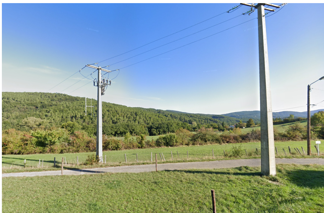
Ligne haute tension au niveau de la route des Sablas - Source : googlestreetview
