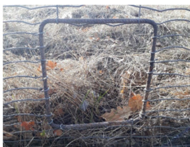
Trouée à la base de la clôture permettant le passage de la petite et moyenne faune.
