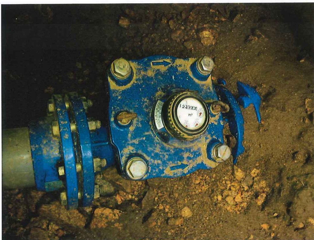
Photo du Compteur C3 – Distribution d'eau à partir du réservoir du Village vers le Chef-Lieu
