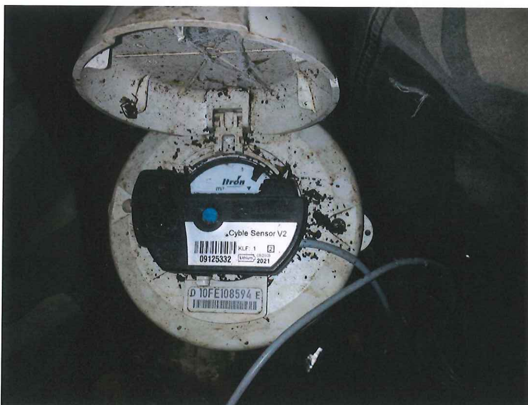
Photo du Compteur C9 – Distribution d'eau en sortie du réservoir des Vernées
