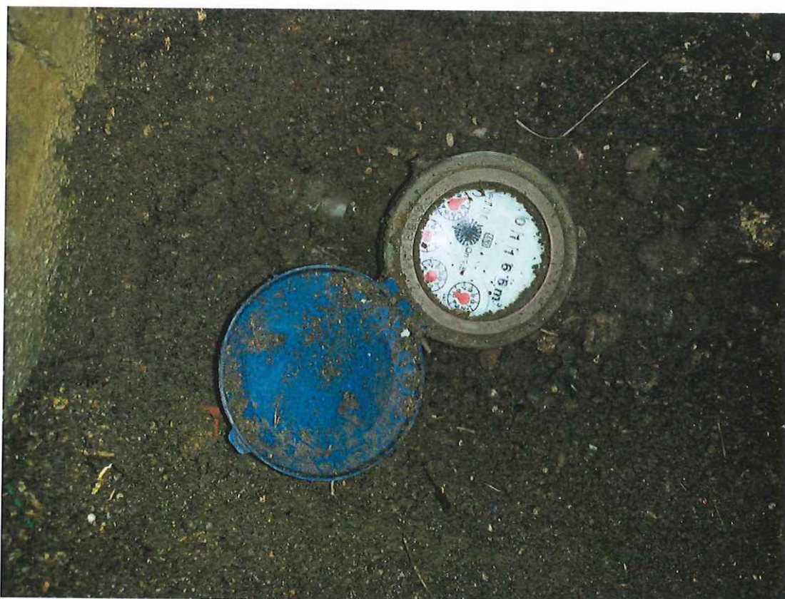
Photo du Compteur C6 – Distribution d'eau vers les vestiaires du stade
