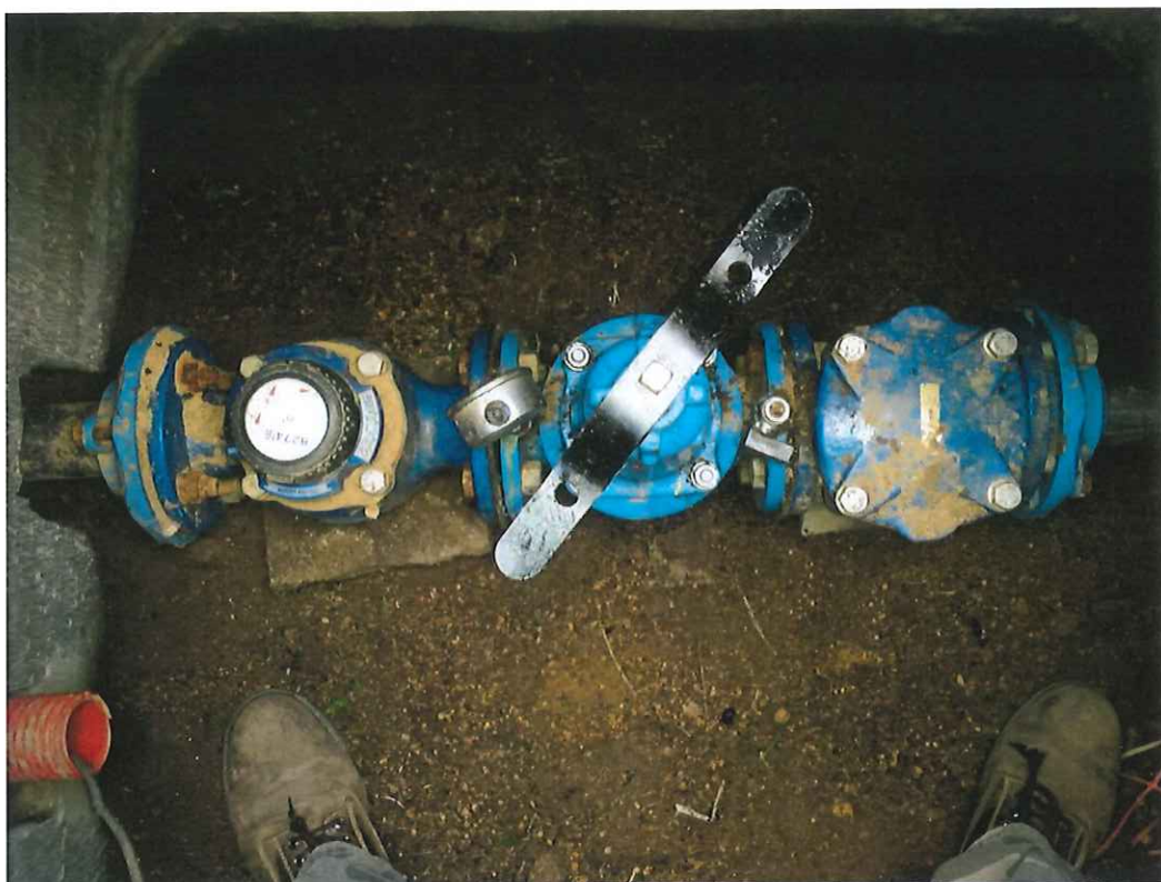
Photo du réducteur de Pression RP1 – Réservoir du village
