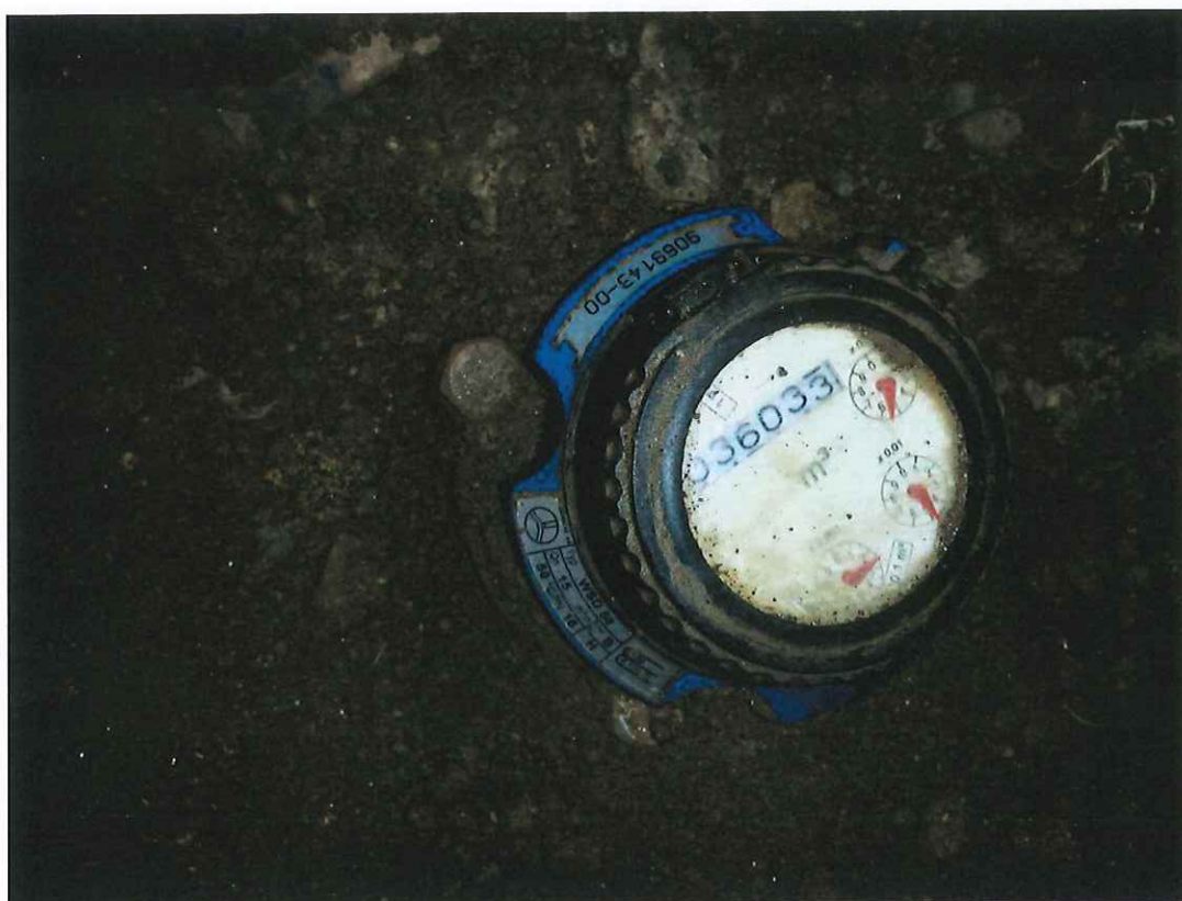
Photo du Compteur C7 – Distribution d'eau vers le stade de football
