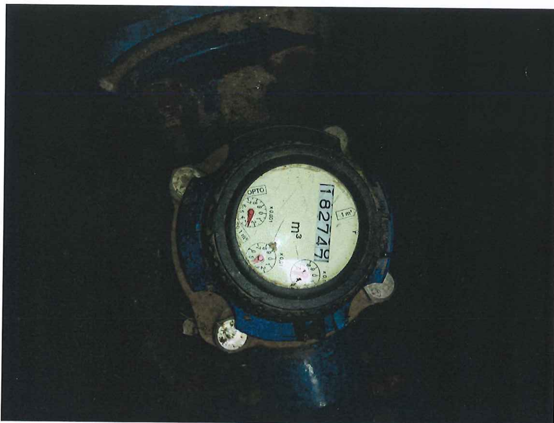
Photo du Compteur C2 –Alimentation du réservoir du Village
