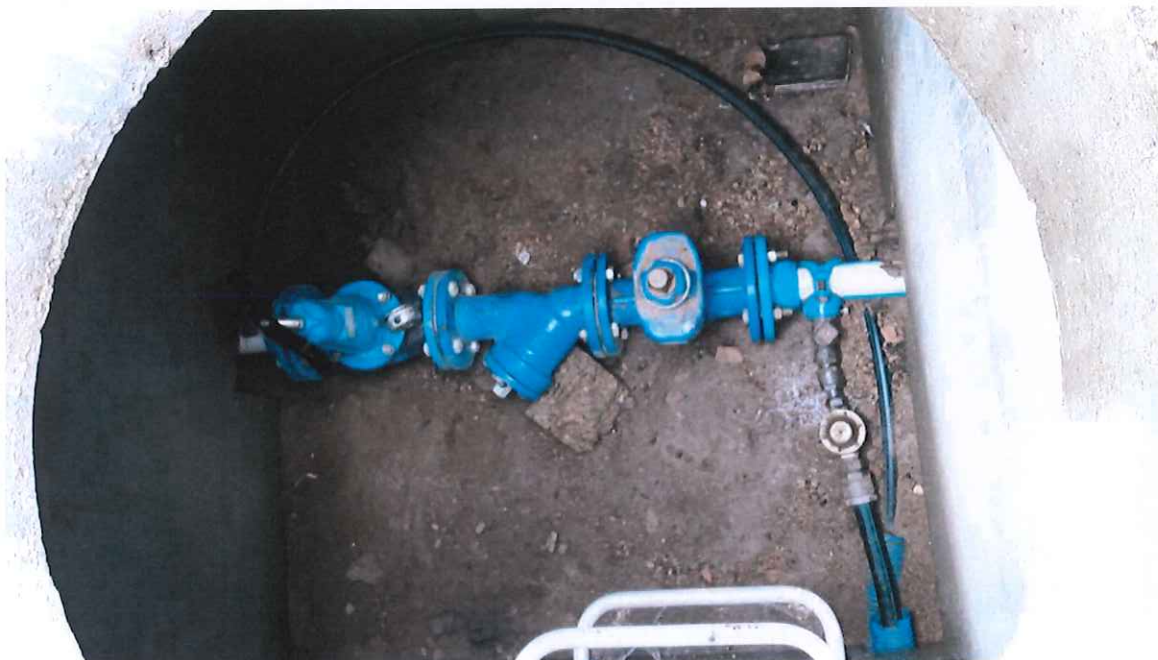
Photo du réducteur de Pression RP19 – Réservoir de la Grange
