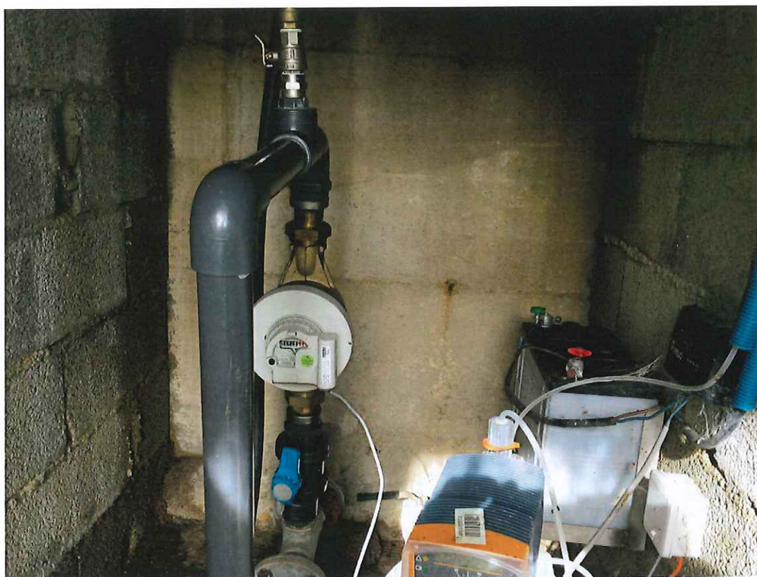
Photo du Compteur C8 – Distribution d'eau en sortie du réservoir du Chier
