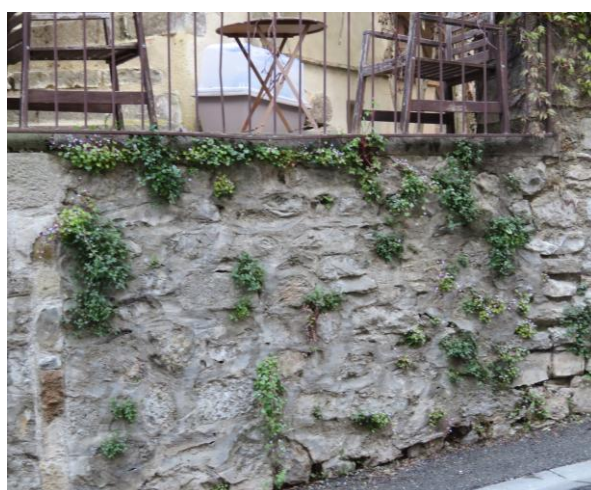
Vieux murets fissurés laissant se développer la végétation
