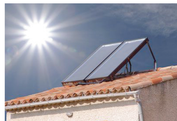
Panneaux rajoutés sur la toiture et non intégrés à la pente du toit
